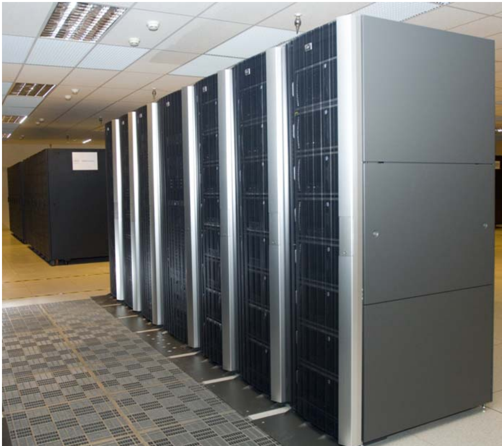
Le cluster de dépouillement du CCRT
