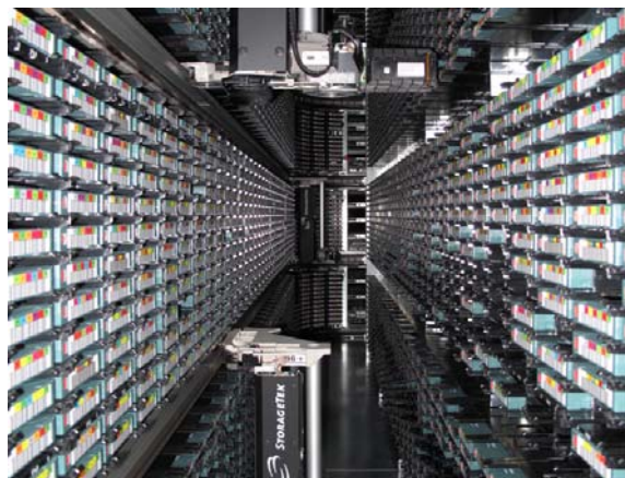
Intérieur d'un silo Sun/StorageTek : alvéoles de stockage des cartouches et main (au centre)
