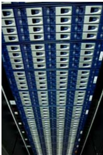
Baie de disques (sous-ensemble)
