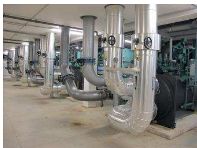
Un groupe de production d'eau glacée dans l'un des «data centers» du Commissariat français à l'énergie atomique et aux énergies alternatives, en région parisienne.
